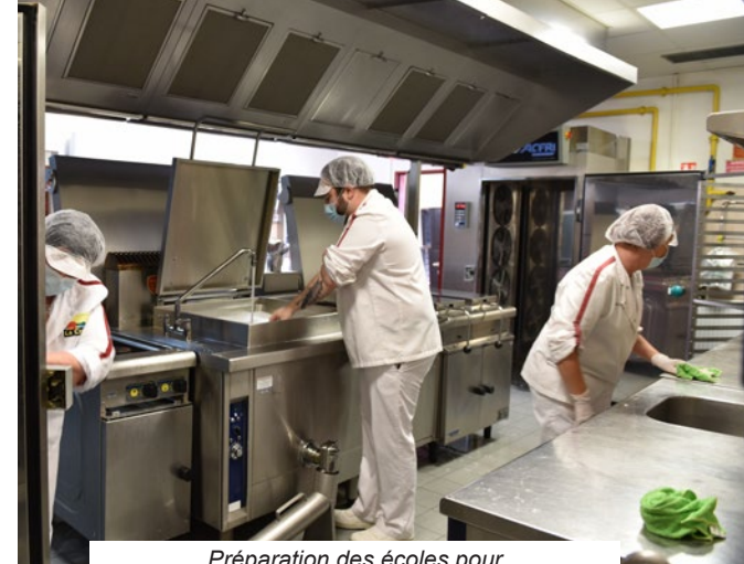
Préparation des écoles pour la première phase de déconfinement
