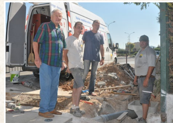
Après la fabrication, Gérard SIMON participe également à la pose des éléments, ici le portail de l'école Marcel Pagnol en 2011. Au centre, Alain ROQUEBRUN, et deux employés municipaux, dont Eric LACHIZE à droite
