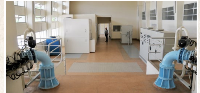
Gérard SIMON dans la salle de commande de l'usine traitement de l'eau de Carnoules.
